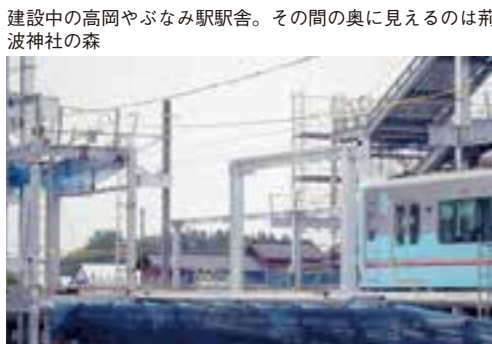
建設中の高岡やぶなみ駅駅舎。その間の奥に見えるのは荊波神社の森
